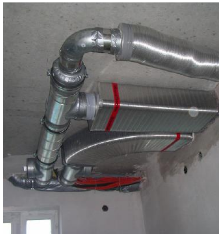
Abbildung 67: Zentrales Zu-/ Abluftsystem mit Wärmerückgewinnung mit Schalldämpfern
